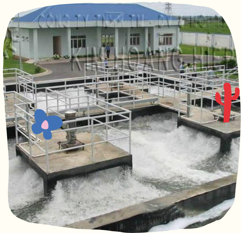
Xử lý nước thải
